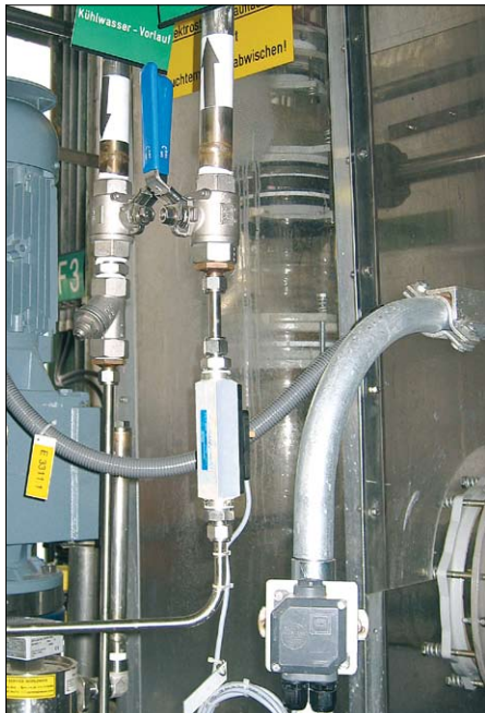
Um ausreichende Kühlung sicherzustellen, überwachen Strömungswächter den Kühlmittelfluss im Wärmetauscher
